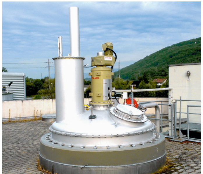
Fig. 4 Die gasdichte Abdeckung auf der ARA Aarburg, die sowohl bezüglich der Reduktion der Methanemissionen positive Erfahrungen macht als auch die Investitionen dank dem Förderprogramm von South Pole bereits kompensieren konnte. (Foto: ARA Aarburg)
