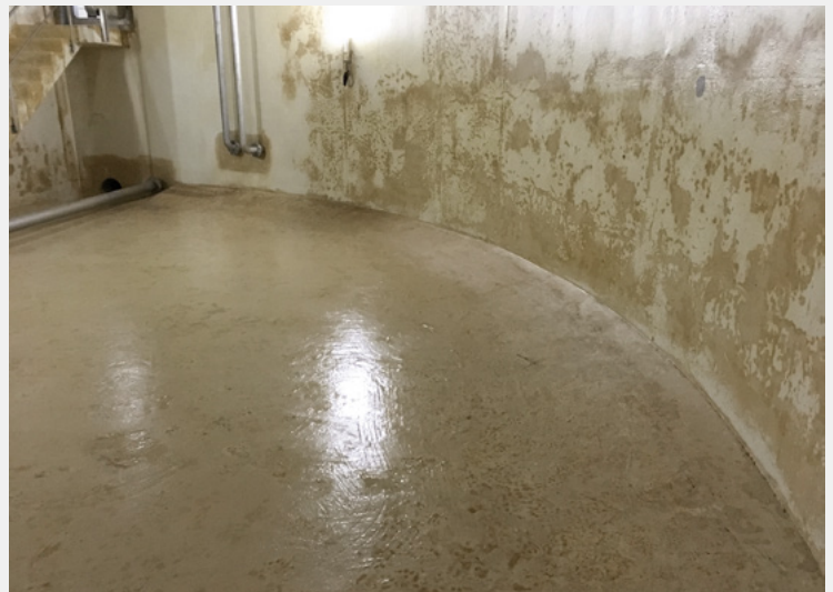
Fig. 1 Reservoir Wahlen mit schadhafte Kammerinnenflächen vor der Sanierung.
