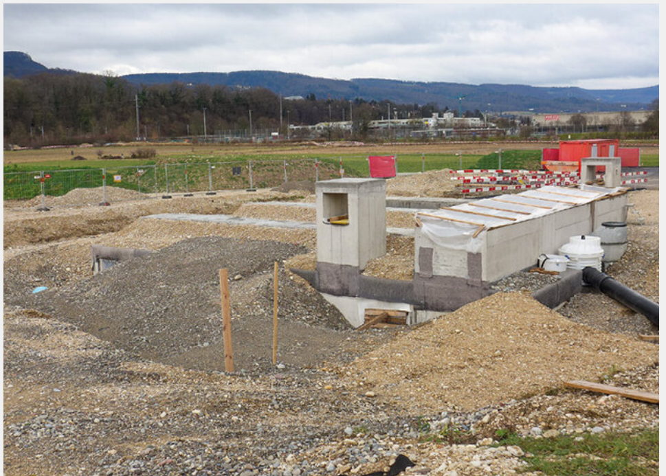
Fig. 6 Umsetzung einer Massnahme aus der Regionalen Planung (Neubau regionales Stufenpumpwerk und Verbindungsleitung)
