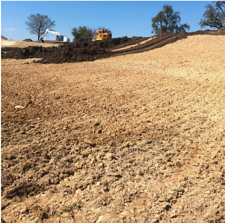
Für die erste Variante des Golfplatzes Meggen waren grosse Bodenverschiebungen in Fruchtfolgefächern geplant. Erst ein neues Projekt mit minimalen Geländeanpassungen erhielt die Baubewilligung.
