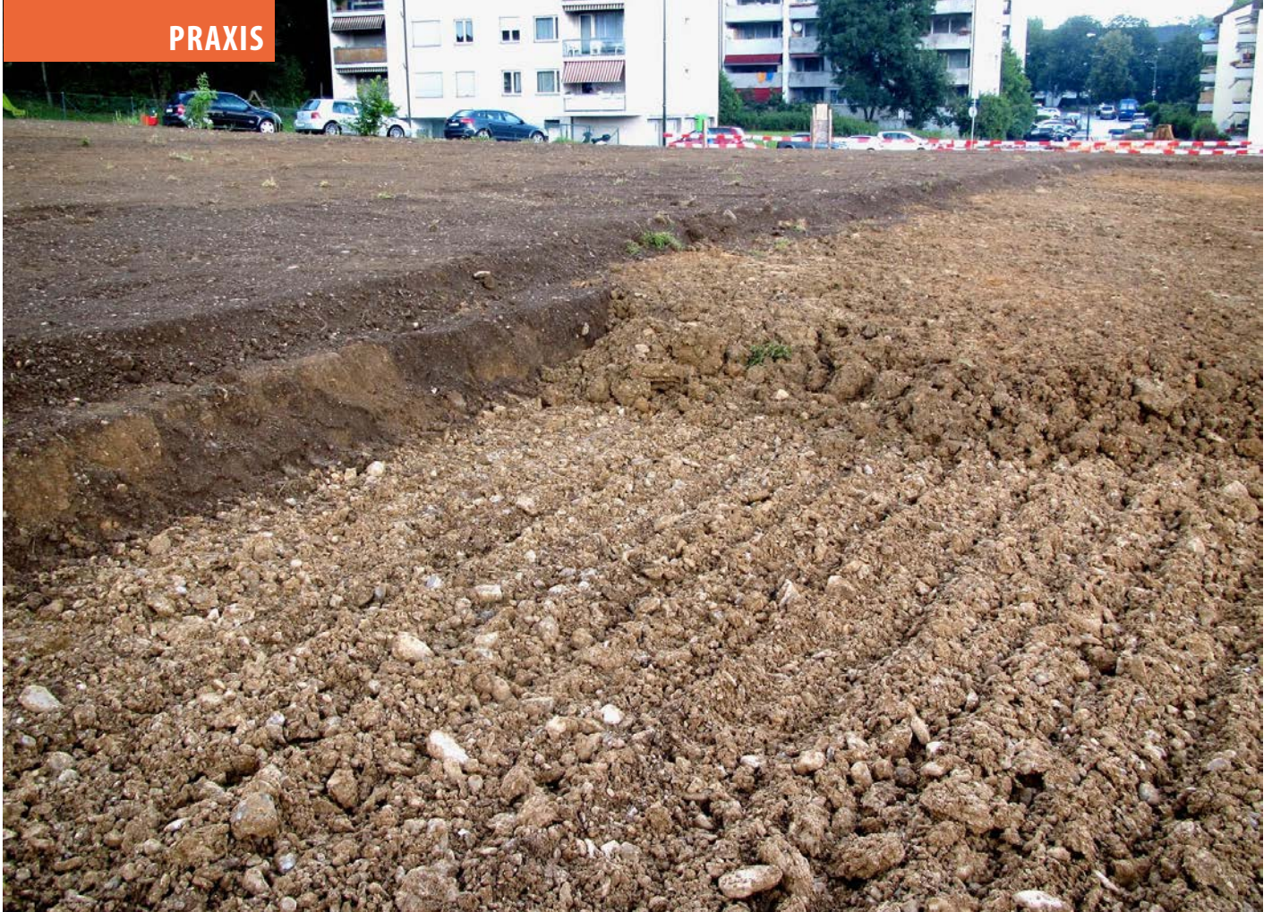
Streifenweiser Wiedereinbau des Ober- und Unterbodens bei der Wohnüberbauung Brunnenmattweg in Luzern.
